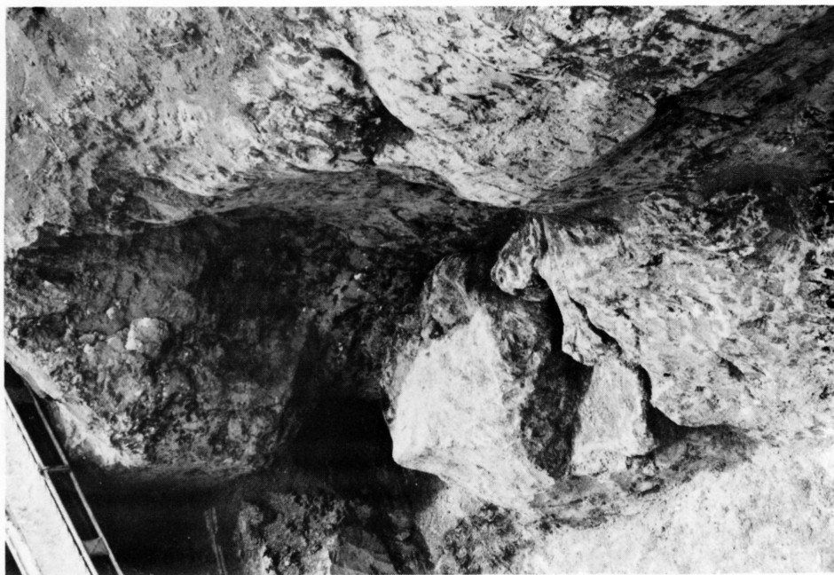
2. 隧道側壁陥没状態 (西から)
