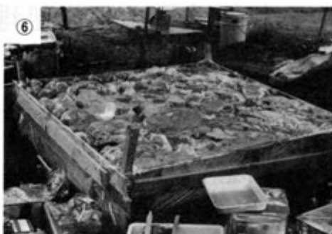
⑥ 表面に発泡ウレタン樹脂を流し込み、さらに頑丈に固定する。発泡ウレタンの節約のため、ビニール袋等で風船をつくり、つめる。発泡が始まったら板等で圧力をかけ平らにする。 薬剤：ハイプロックス（主剤・硬化剤）主剤対硬化剤＝1対1
