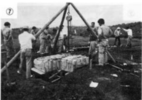
⑦ 発泡ウレタン樹脂が固まったら、天地を逆にするためフタをし、遺構を台地と切り離しながら裏打ちをする。ショック防止のため、ウレタンフォームをフタとの間に入れたり、すじかいをしっかりとる。
