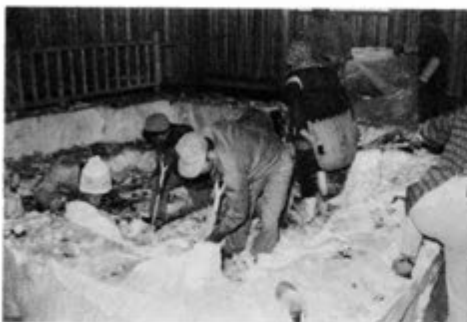
⑨ 建物建設終了後、梱包を解き、ウレタン及び鋼管を除去し、遺構壁面は崩壊をしないように、化学処理で補強作業を実施する。 薬剤：サンコール樹脂：サンコールシナー
