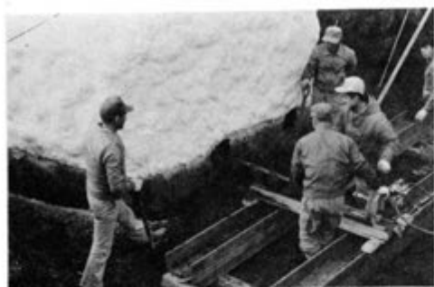
③ 分離するために、床面下位にH鋼貫入のため、水平ボーリングを実施する。
