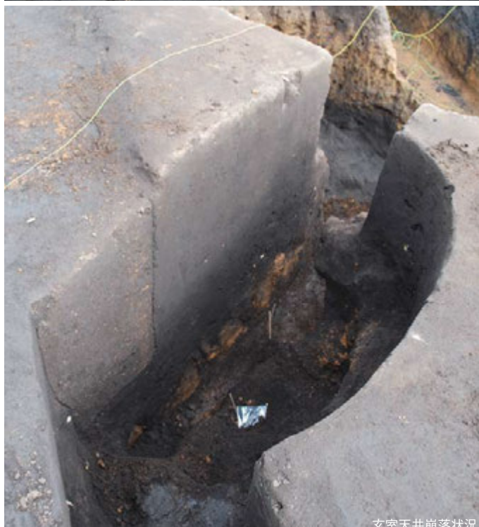
玄室天井崩落状況
