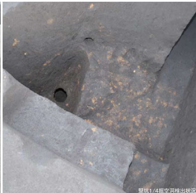
豎坑1/4掘空洞検出状況
