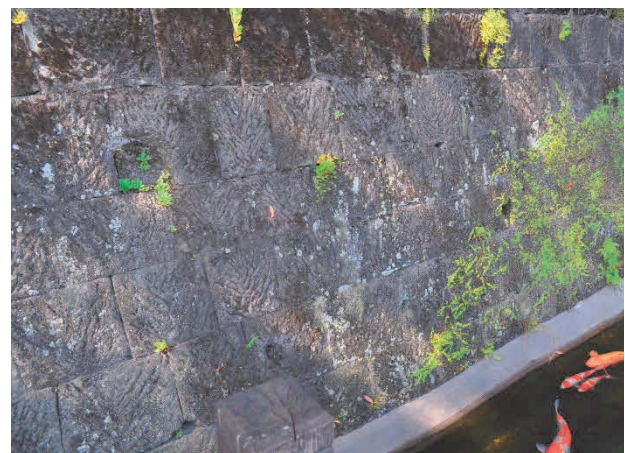
写真13 弾痕のある二ノ丸石垣
