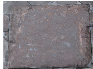
柱の金物の錆跡が残る鏡柱部分の礎石 （幅約 1.2m、高さ約 1m）
